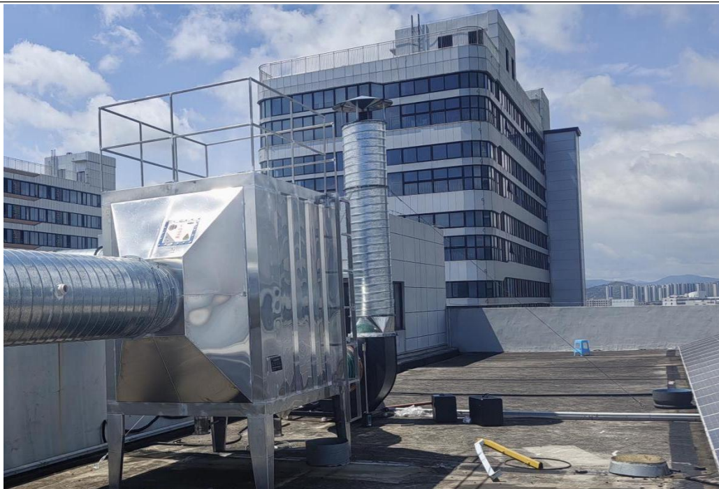
冷粘废气处理设施
