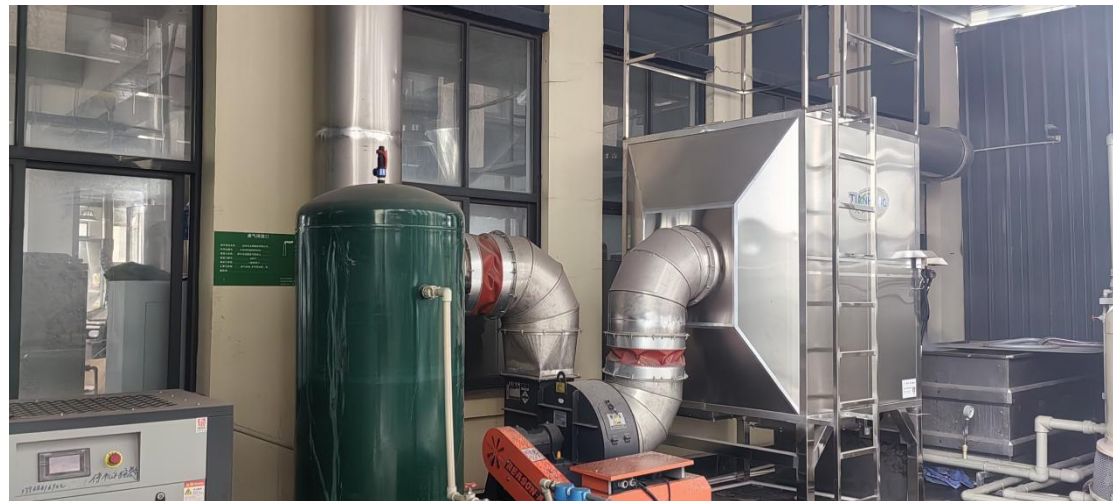
挤出及注塑废气处理设施
