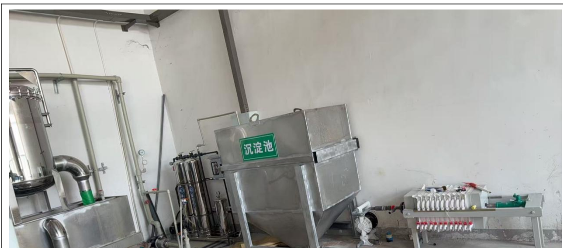
间接冷却水处理设施
